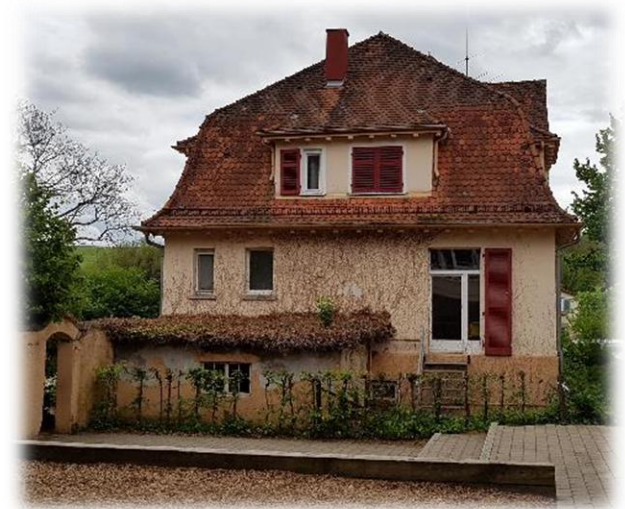
Das renovierungsbedürftige Gebäude in der Schulstr. 21
